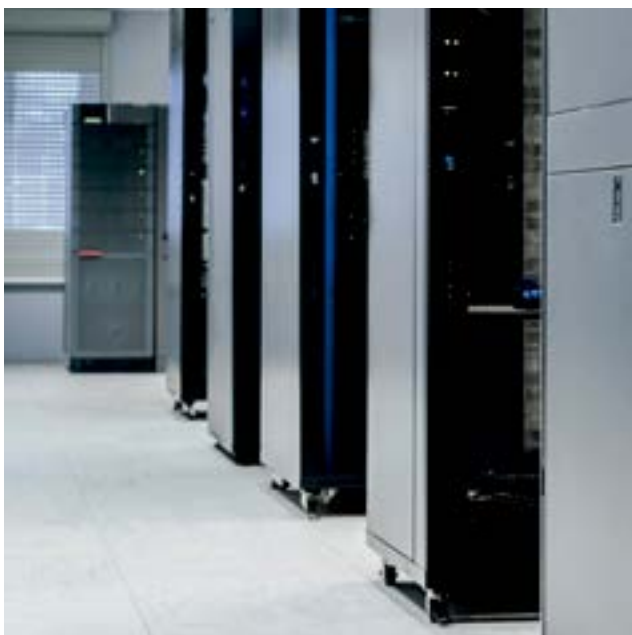
CENTROS DE DATOS / SALAS DE SERVIDORES
